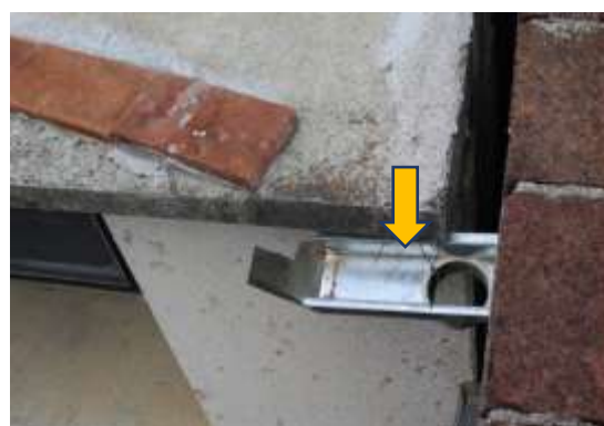
Figura 11. Detalle de canaleta para encausar el agua de lluvia.
