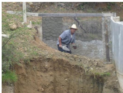
Figura 8. Aplanado lateral interno margen izquierda en ausencia de empotramiento.
